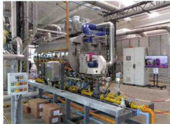
Le démonstrateur est assemblé dans les locaux de Babcock Wanson à Nérac (47).
